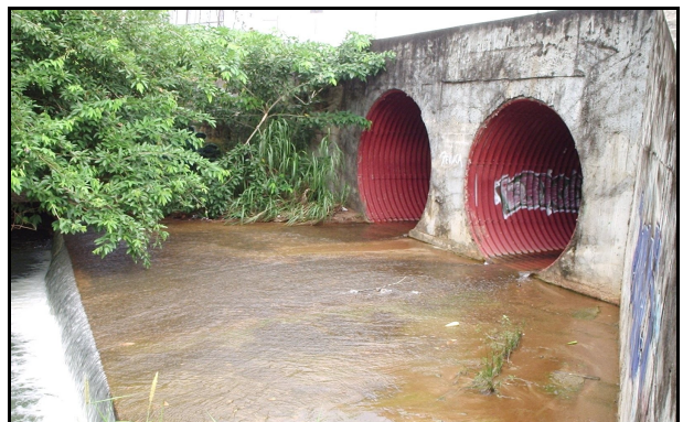
Figura 18 - Ponto P15 – Igarapé Caxangá – Elevatória de esgoto da CAER - N 02° 25' 19,4"; W 60° 40' 03,0". Localizado na cidade de Boa Vista, constituindo parte de sua rede de drenagem.
