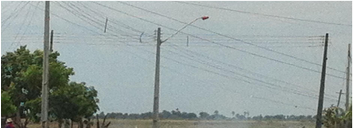
Fotografia 3 . Desvio de energia elétrica no Conjunto Cidadão
