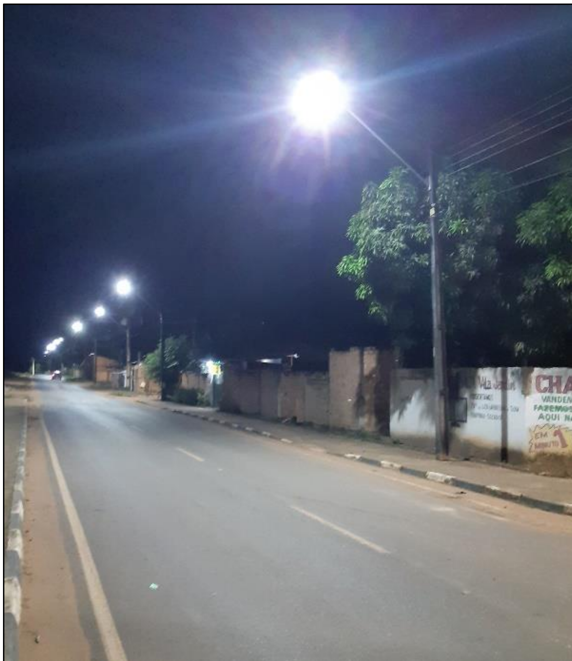
Figura 38 - Iluminação pública no bairro Cidade Satélite
