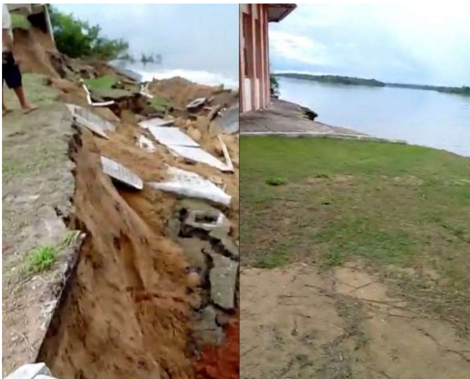
Figura 7 – Vista parcial das áreas de risco da cidade de Caracaraí - RR.
