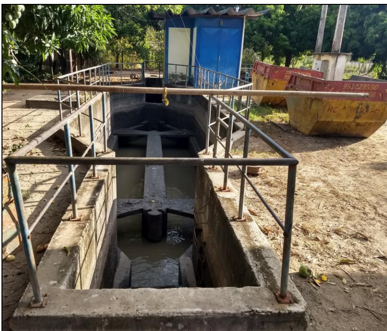
Figura 31 – Casa de comando situada ao fundo (EEE Mirandinha), situada no bairro Canarinho.
