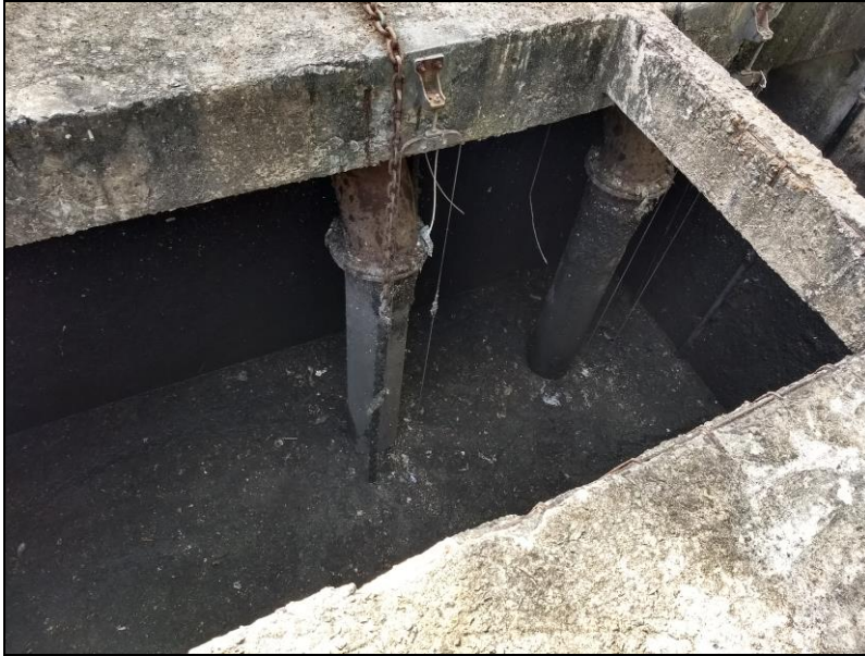
Figura 30 – Poço de sucção da EEE do Mirandinha.
