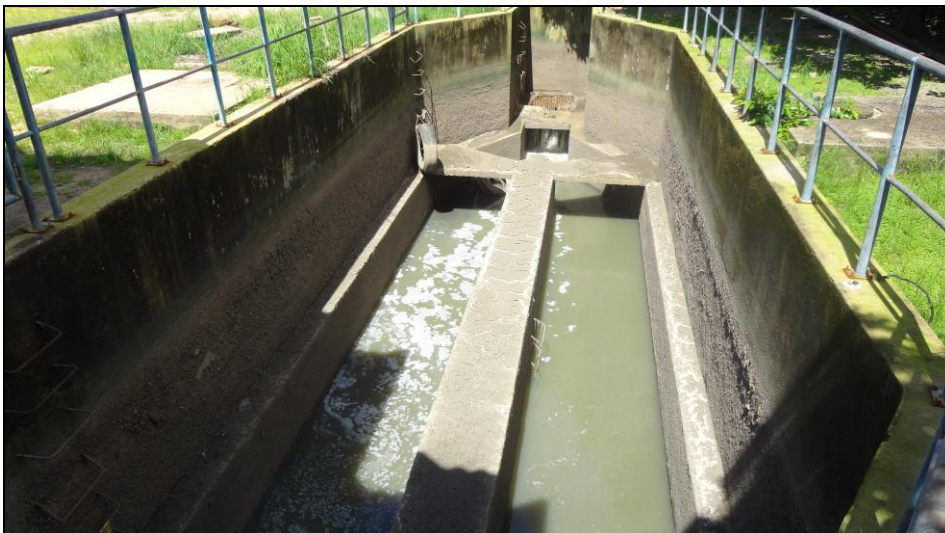
Figura 29 – Unidade de pré-tratamento da EEE do Mirandinha: gradeamento e caixa de areia.
