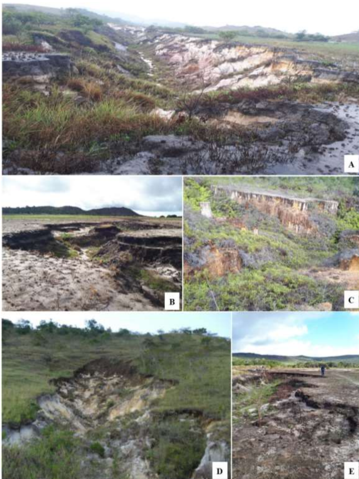
Figura 35 – (A) Voçoroca do Barata em área plana em constante evolução; (B) Voçoroca do Meio; (C) Voçoroca do Paiva (D) Voçoroca observada na área de encosta da serra do Tepequém e (E) Voçoroca da Lixeira.
