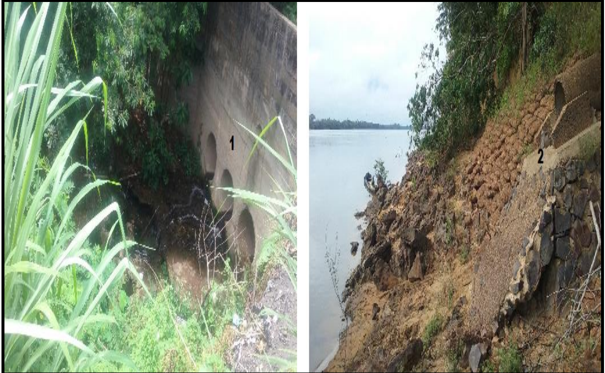
Figura 19 – Esgoto canalizado (1) utilizado e estrutura canalizada (2) não utilizada.
