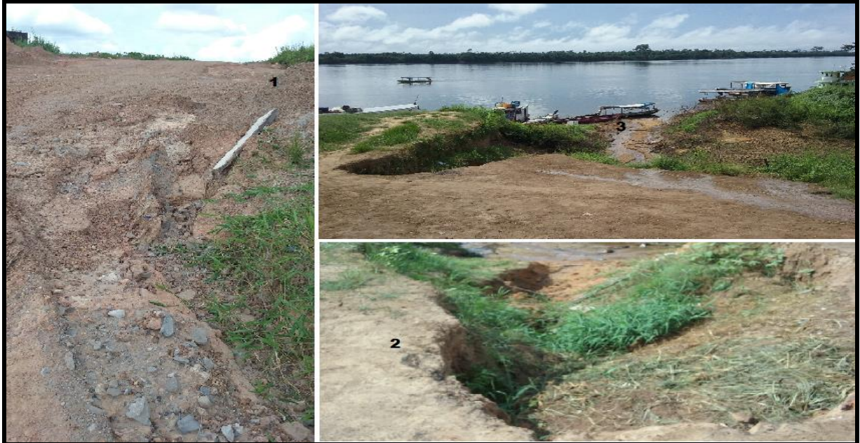
Figura 21 – Destacando os processos erosivos ao longo da margem direita do rio Branco em Caracaraí, (1) sulcos, (2) ravinas e (3) voçoroca.
