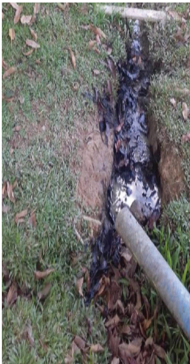
Figuras 3: Rede de esgoto na comunidade indígena bananal
